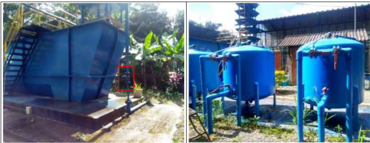
Fotos 17 y 18: PTAP: tanque principal de procesos, macromedidor (demarcado) y filtros.
