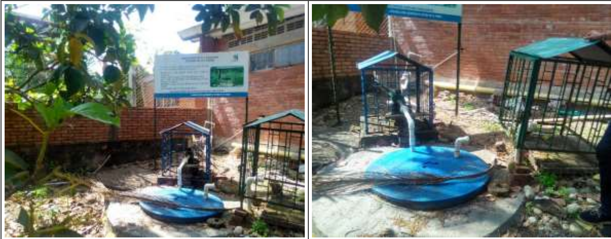
Fotos 1 y 2: Aljibe Piscina, con su sistema de captación y derivación.
