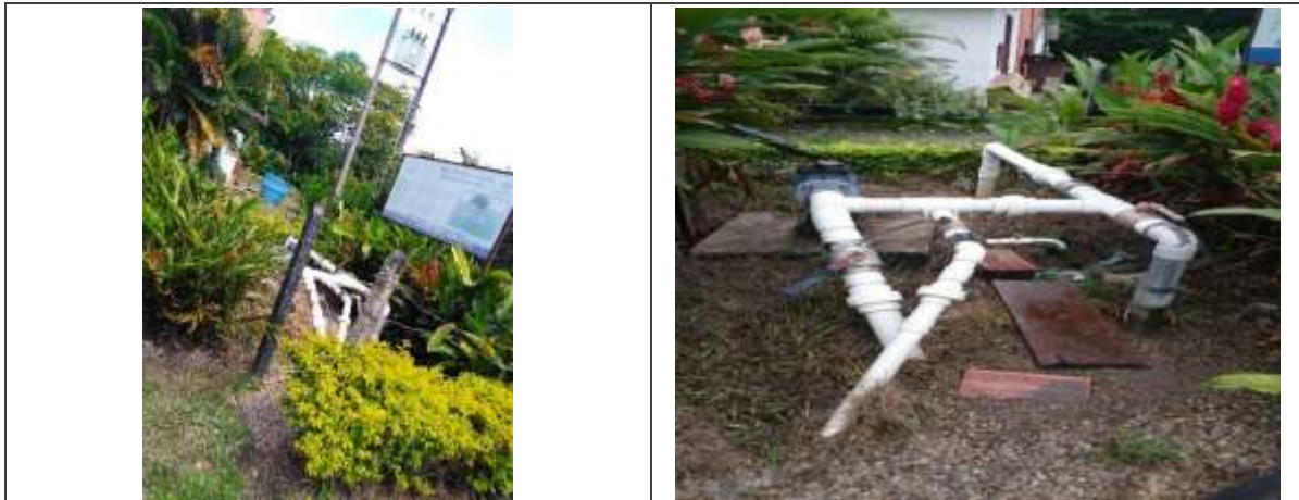
Fotos 11 y 12: Pozo IALL, con su sistema de captación, derivación y medidor de caudal.
