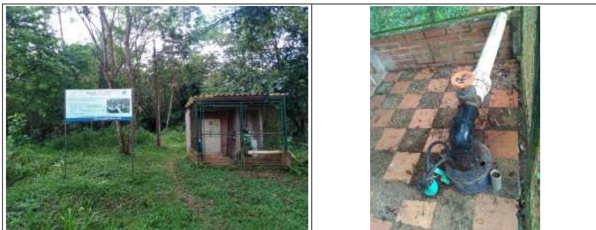
Fotos 13 y 14: Pozo PTAP, con su sistema de captación y derivación.
