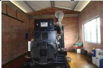
Imagen 3. Planta de Emergencia 600kVA
