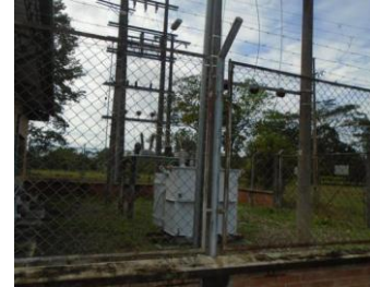
Imagen 2 Transformador de 34500/13200, 1MVA.
